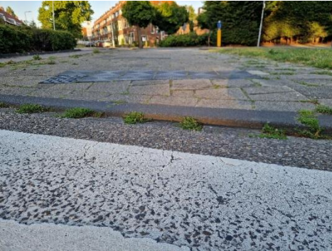
Niet verlaagde trottoirband bij Zeemanlaan.
